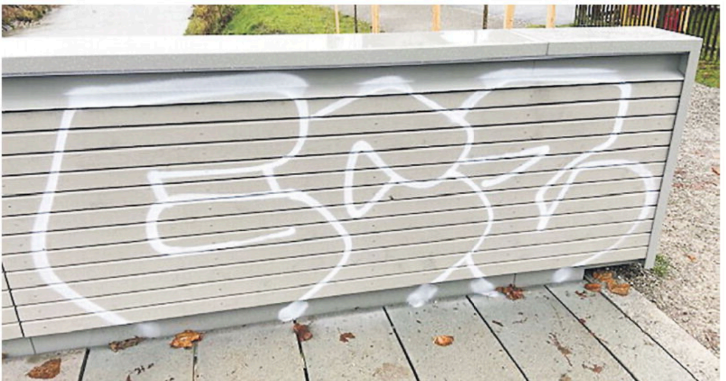
Für besondere Empörung bei der Einsiedler Bevölkerung sorgten die Sprayereien auf der Fussgängerbrücke über die Alp.
